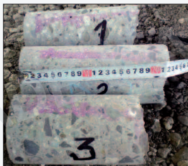
Figura 3 - Le indagini sul livello di degrado sul conglomerato cementizio
